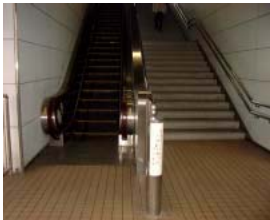
図 南千歳駅構内エスカレーター
