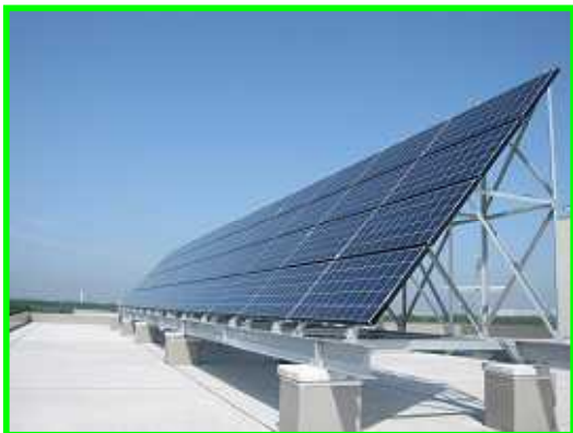
太陽光発電設備
